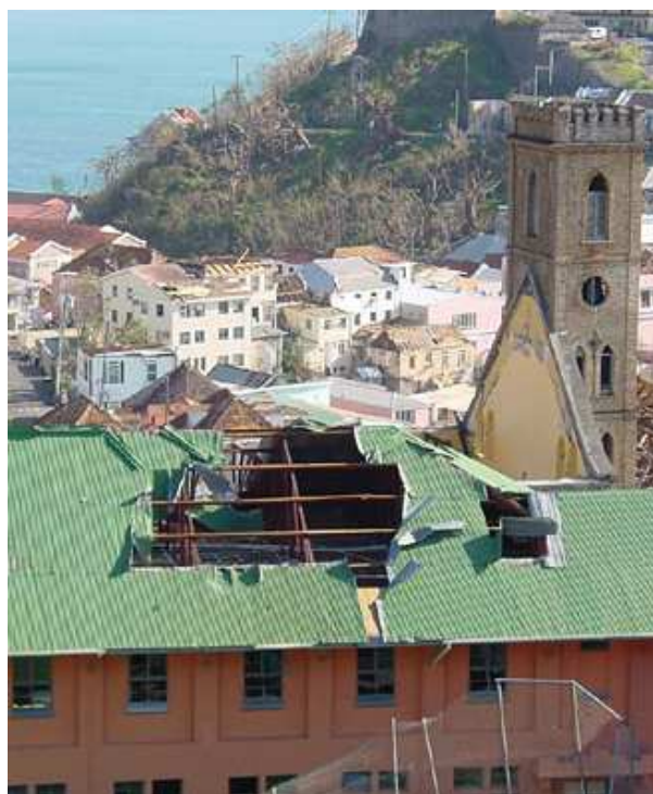
L'ouragan Ivan et ses vents d'une extrême violence n'ont rien épargné sur leur passage lorsqu'ils ont balayé la Grenade. La structure de 90 % des bâtiments de l'île a été endommagée, l'électricité complètement coupée, et l'alimentation en eau totalement interrompue durant les premiers jours qui ont suivi la catastrophe.
